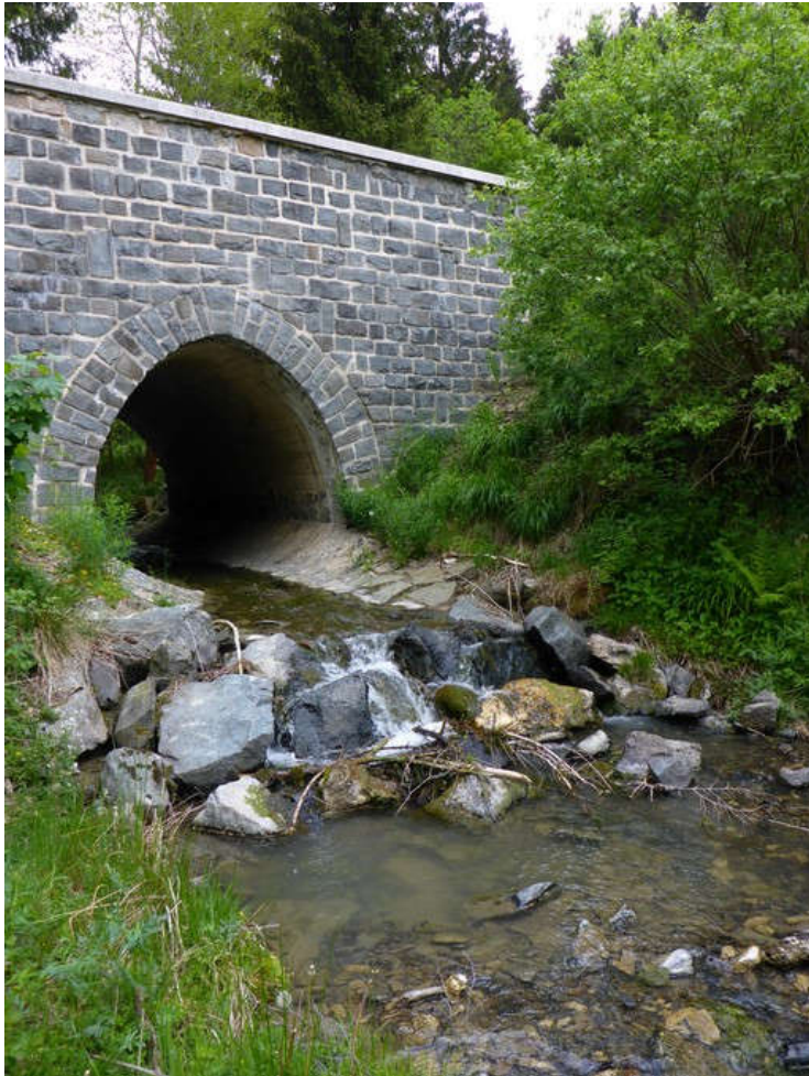
Abbildung 2: Absturz unterhalb der Brücke des Talsperren-Rundweges
