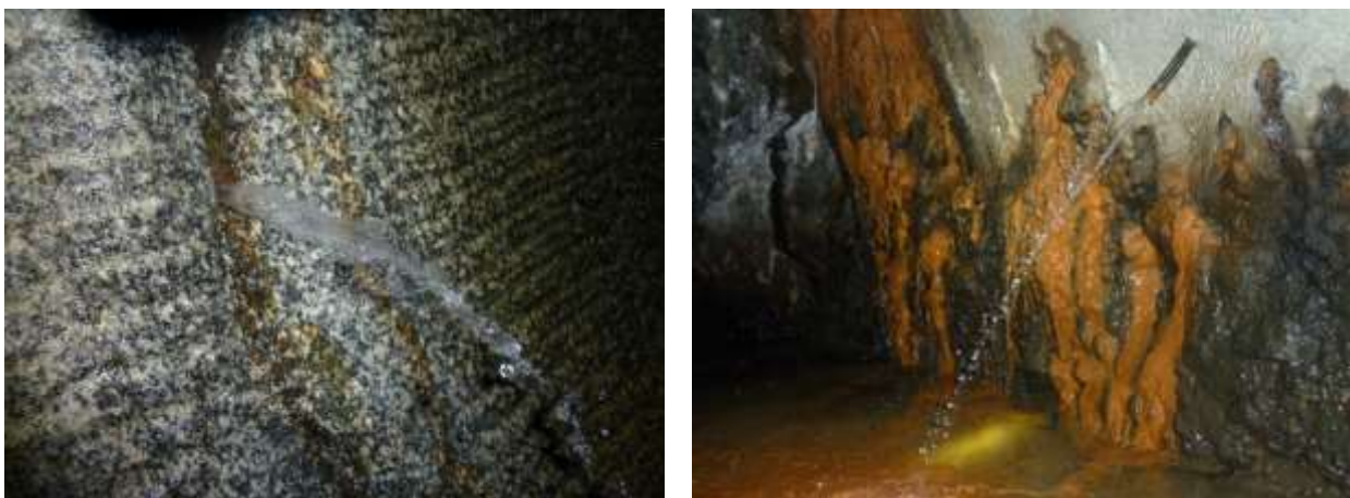
Abbildung 3: Zuflüsse in den Radaustollen aus dem umliegenden Gebirge
